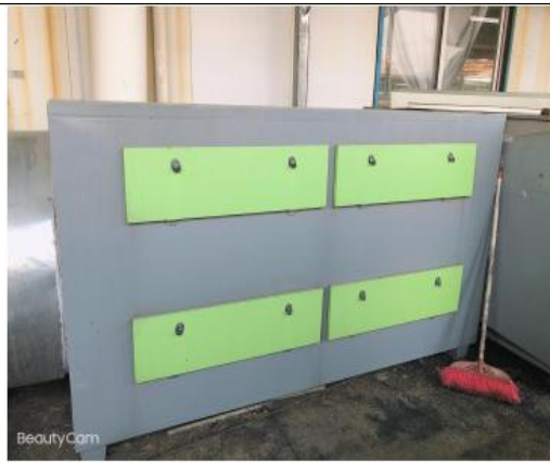
A 栋厂房活性炭吸附装置
