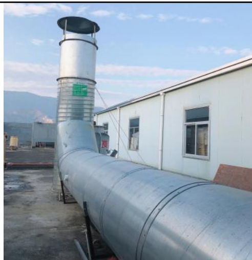
DA002 排气筒（30 米）
