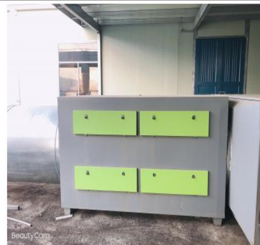
C 栋厂房活性炭吸附装置
