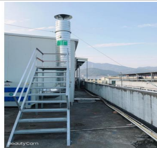
DA001 排气筒 (25 米)
